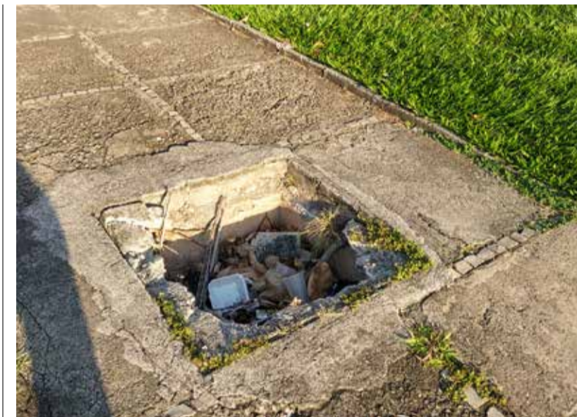
OLHO NO CHÃO buraco no passeio que leva à portaria principal
