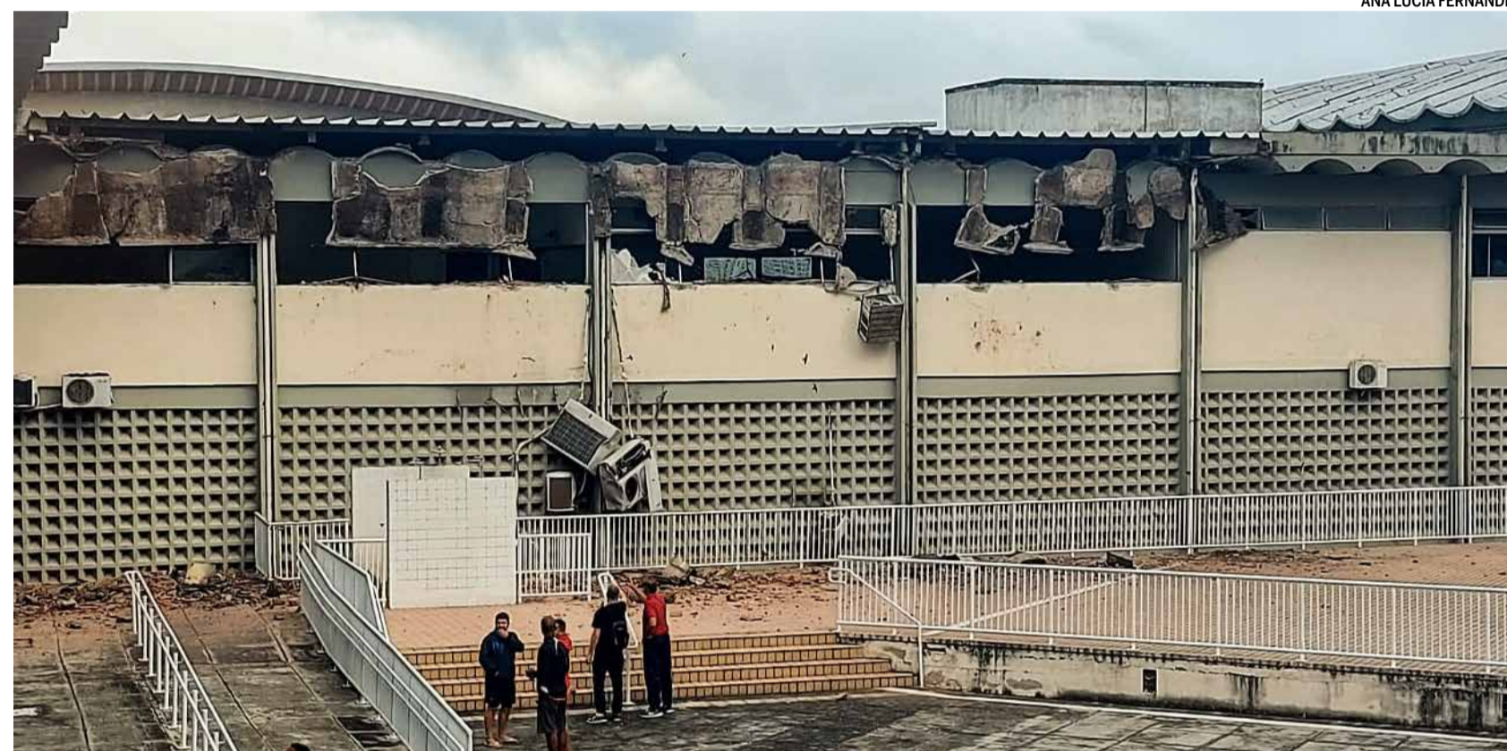
DESABAMENTO DO DIA 6 levou à interdição do prédio e à suspensão das aulas. Comunidade aguarda escoramento emergencial
