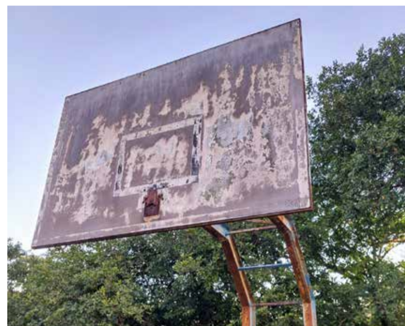
ZERO PONTO quadras externas estão deterioradas
