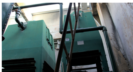
Indicação de saída de emergência, no subsolo do bloco L, não leva a lugar algum
