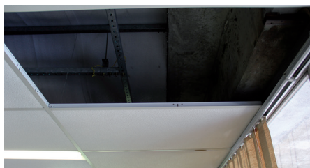
Teto da sala dos docentes apresenta diversos buracos por onde entra água da chuva
