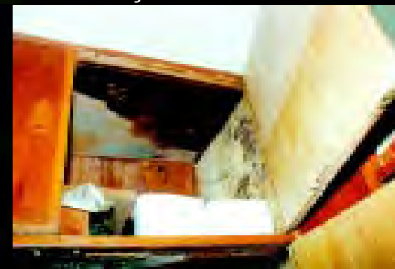
INFILTRAÇÕES INUTILIZAM MÓVEIS
